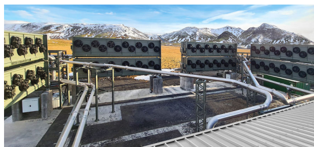
Figure 6 : Illustration d'une installation de capture du \text{CO}_2 dans l'air ambiant en Islande (ORCA), 4000 tonnes de \text{CO}_2 par an, Source : climeworks.com
